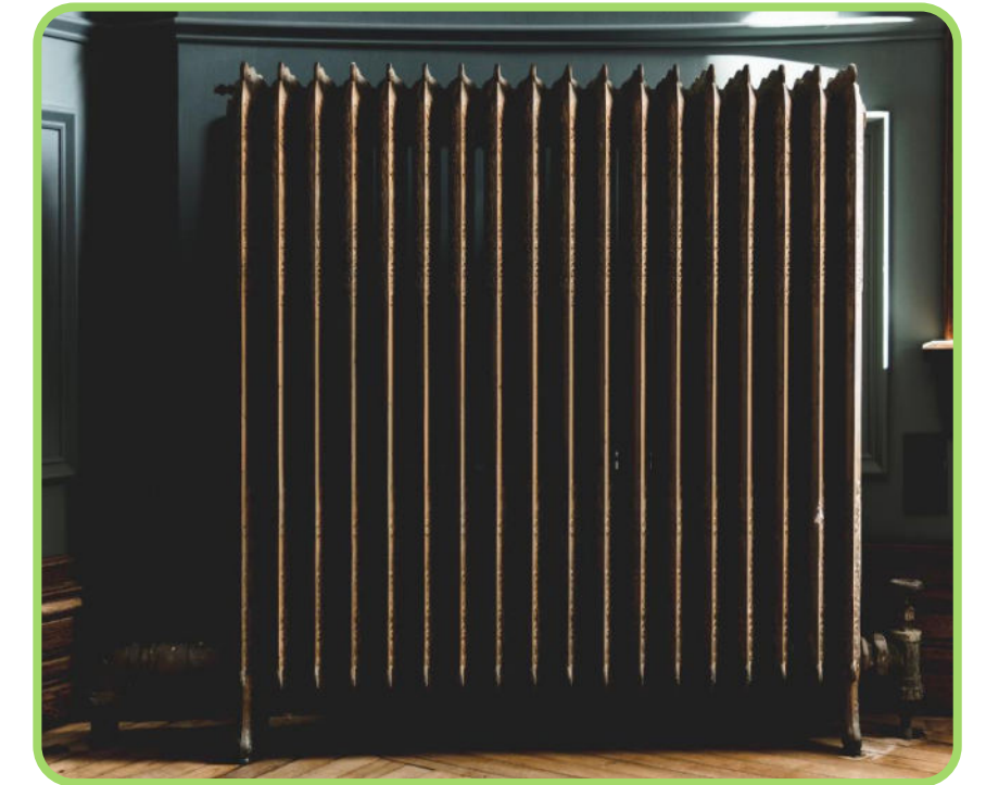
Alte Ölheizung Quelle: Unsplash
