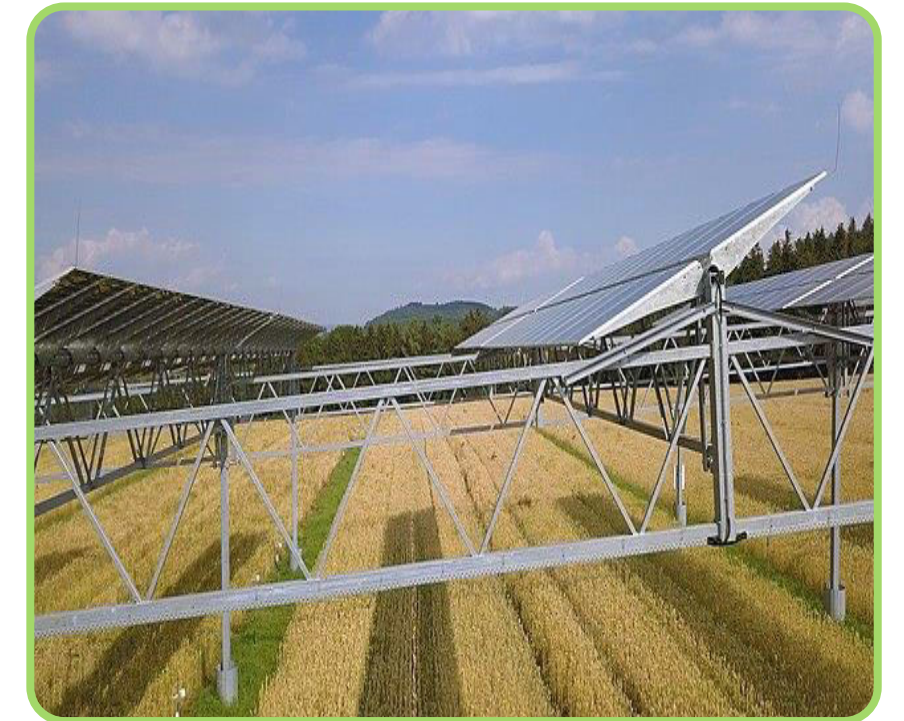
Agri-PV-Anlage in Heggelsbach Quelle: Wikimedia Commons
